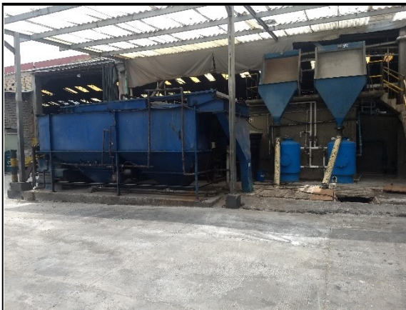
Planta de tratamiento de Aguas
