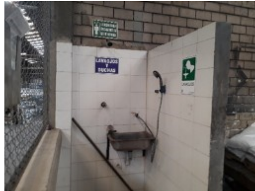
Foto 43. Seguridad y salud en el Trabajo. Detalle de área de duchas y lavajos destinada para casos de emergencia.
